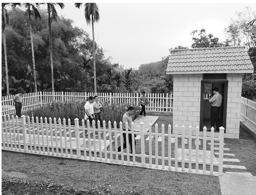
琼中湾岭镇大边村污水处理系统
