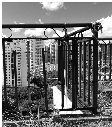
东方文华府楼顶金属护栏锈蚀严重
