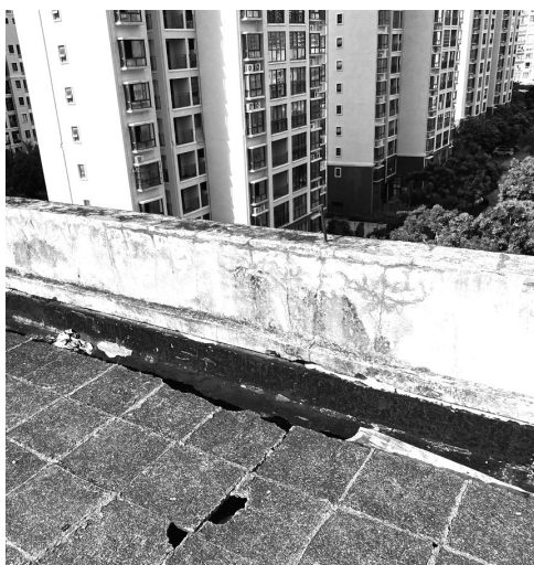
怡昌花园公寓A栋楼顶女儿墙高度过低
